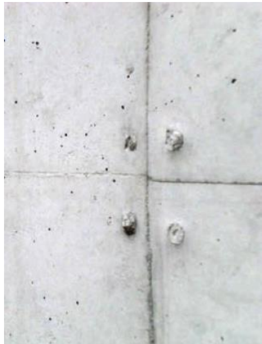
Foto 1.9 Aftekening van schroeven van de plaatbevestigingen in het beton
