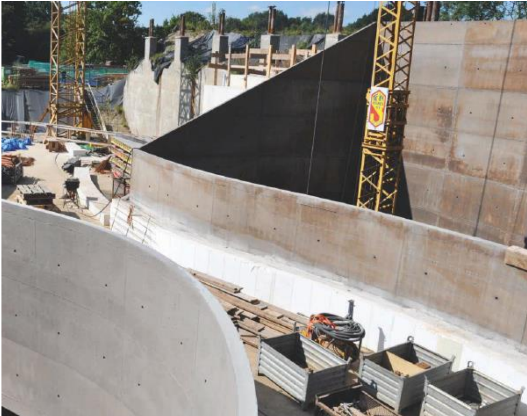
Foto 4.3: Rechts donkere vlekken van ontkistingsmiddel op het schoonbeton in het Waterliniemuseum
