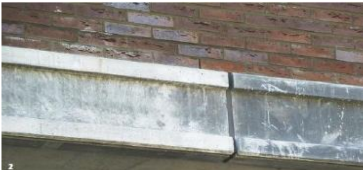
Foto 4.4: Als watergedragen ontkistingsmiddel onvoldoende droogt, komt vrije kalk naar het oppervlak dat wit uitslaat foto: Peter de Vries
