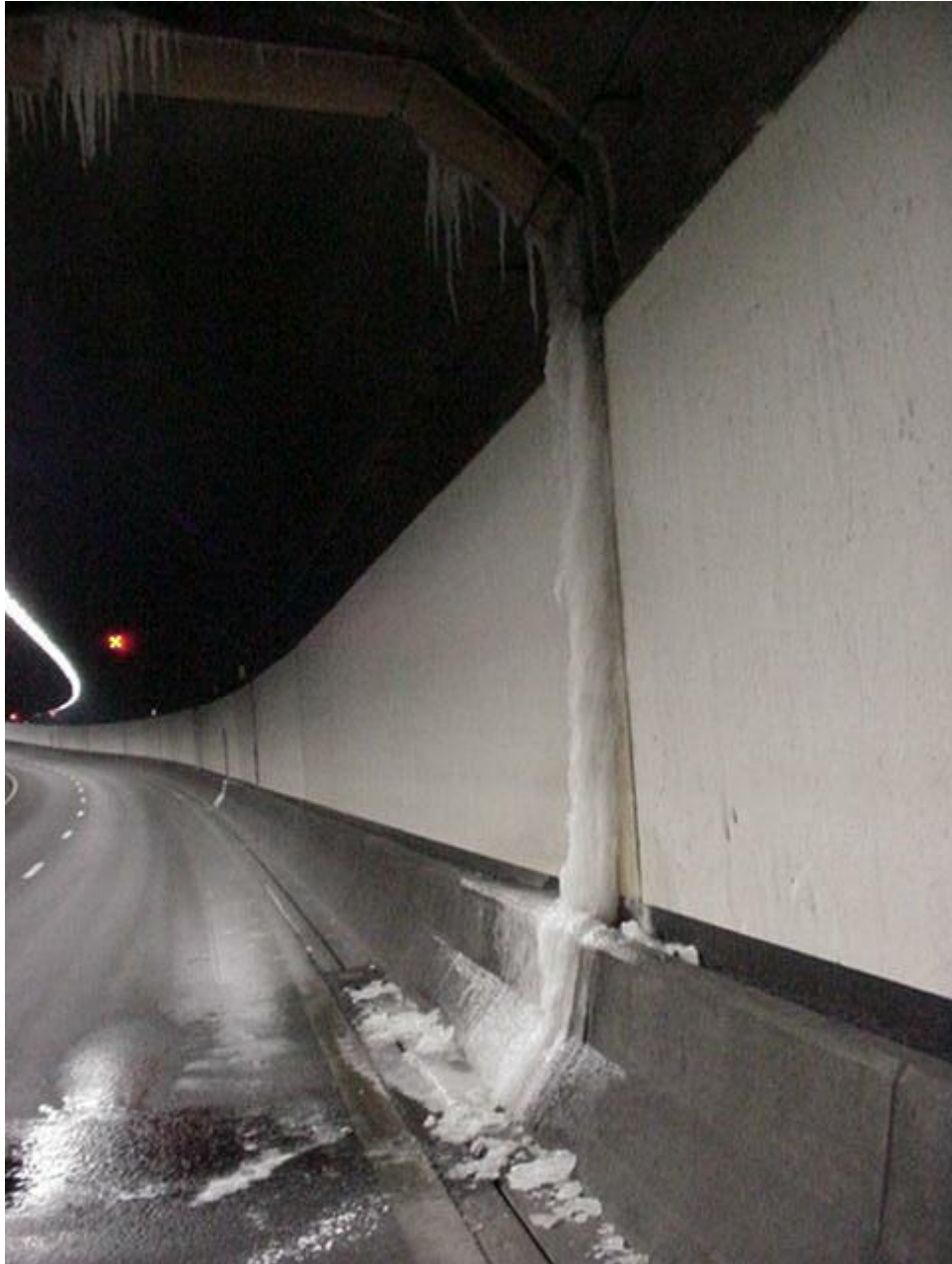
Ijsvorming bij lekkende voeg in Drechtunnel
