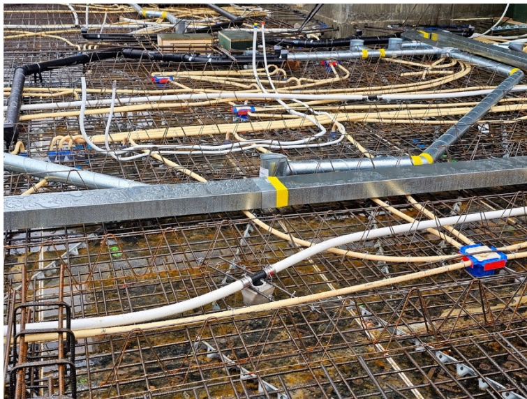
Figuur 13 'Spaghetti' aan leidingen in de vloer
